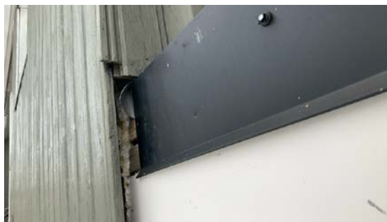
Manglende tetting i overgang mellom opprinnelig del og tilbygd del.
