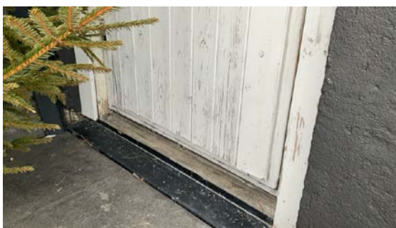
Dør i kjelleretasje med slitasje.
