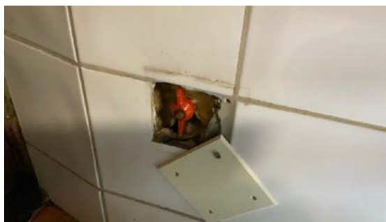
Stoppekran i vegg på bad i kjelleretasje.
