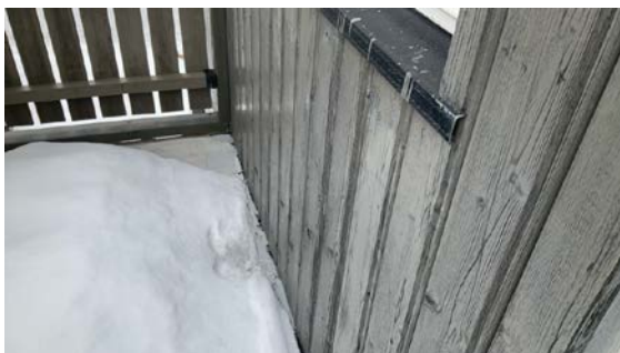
Værslitt og oppsprukket kledning.
