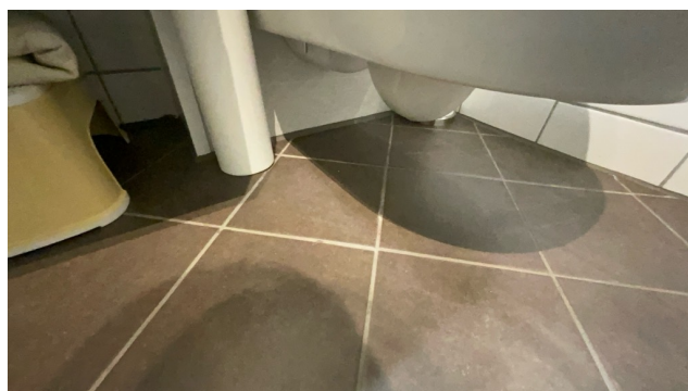
Lekkasjespalte på innebygget sistene bør opparbeides.
