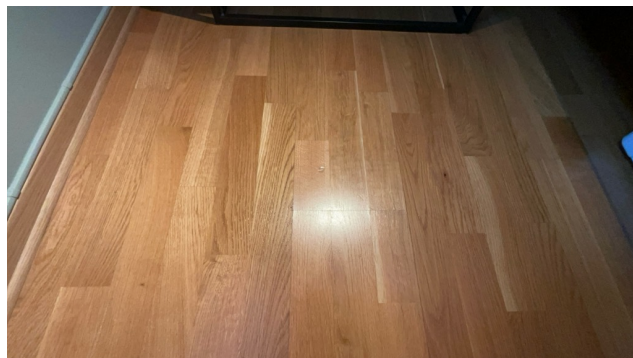
Synlig avvik på parkettgulv.
