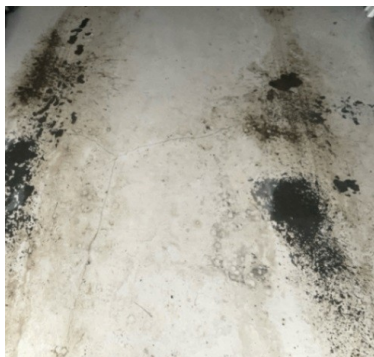
Synlig riss på betongsålen.
