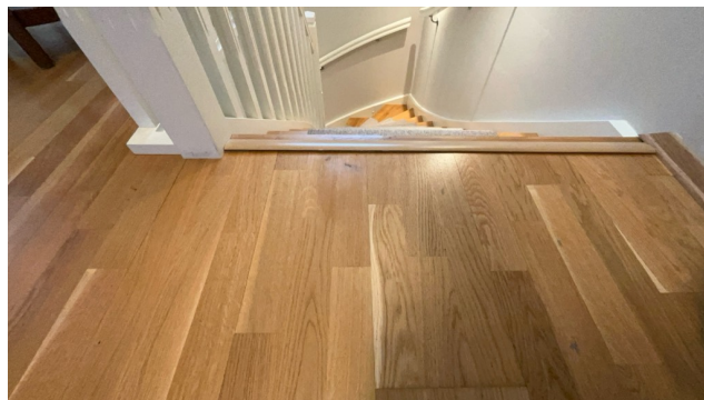
Synlig avvik på parkettgulv.
