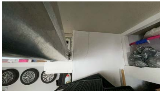
Synlig riss i grunnmur.
