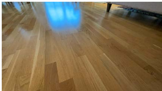
Synlig avvik på parkettgulv.
