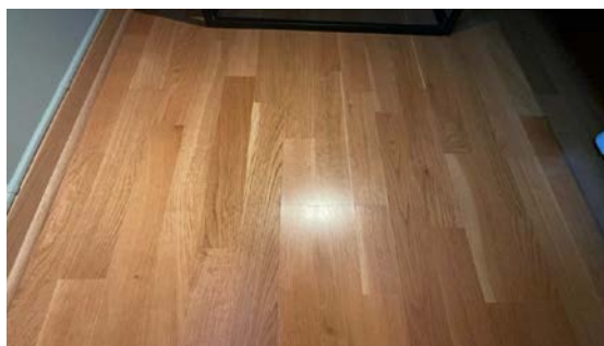
Synlig avvik på parkettgulv.
