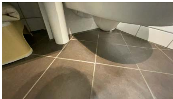
Lekkasjespalte på innebygget sistene bør opparbeides.
