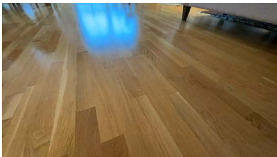
Synlig avvik på parkettgulv.
