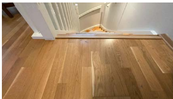
Synlig avvik på parkettgulv.
