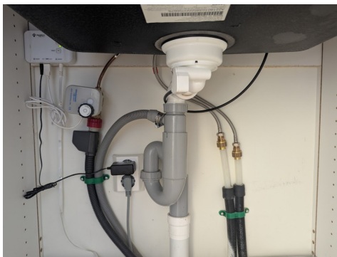
Avløpsrør i kjøkkenbenk
