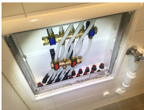
Fordelerskap for rør-i-rør
