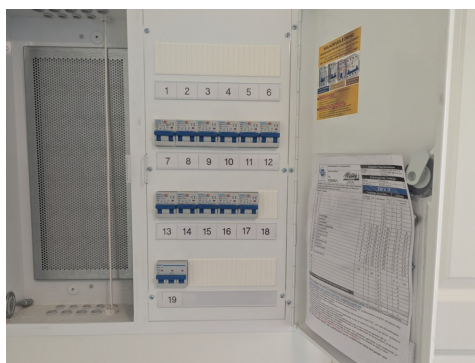
Innmat i sikringsskap
