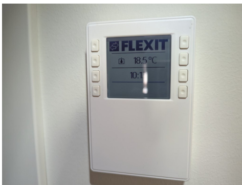
Betjeningspanel for ventilasjon
