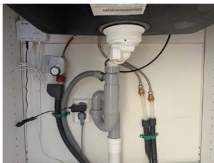
Avløpsrør i kjøkkenbenk
