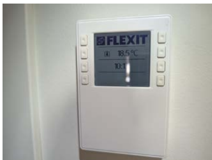
Betjeningspanel for ventilasjon
