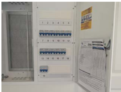
Innmat i sikringsskap
