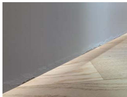
Skade i dørblad på baderomsdør
