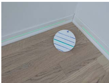
Måling av skjevhet/retningsavvik på gulv (soverom)
