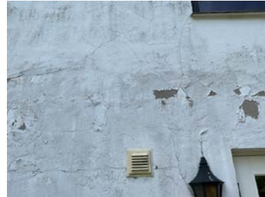
Skader i overflatene.
