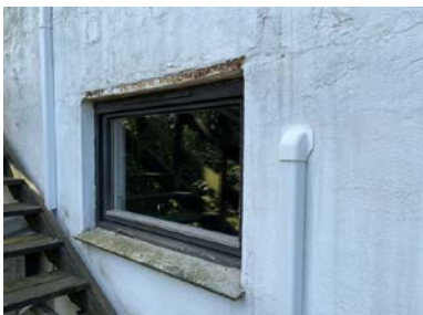
Rust og frostspreng over vinduet.
