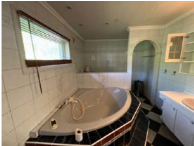
Motfall på deler av gulvet.
