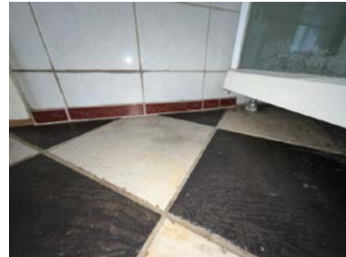
Sprekker mellom vegg og gulv.
