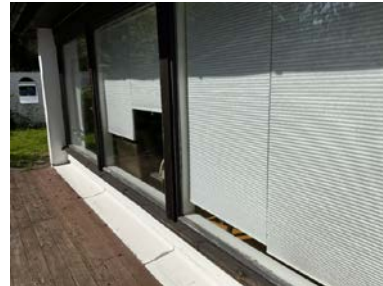
Beslag er montert, ukjent løsning under.
