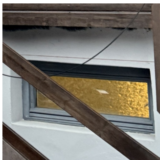
Mangler beslag i bunnen av vindu
