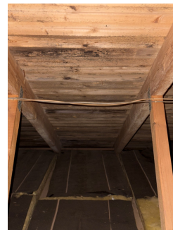
Merker pga. lite utlufting av øverloft
