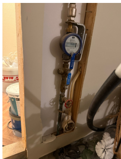
Stoppekran i vaskerom i underetasjen
