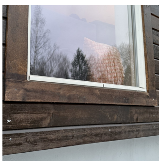
Mangler vannbord i bunn av vindu
