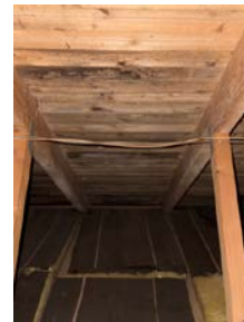
Merker pga. lite utlufting av øverloft
