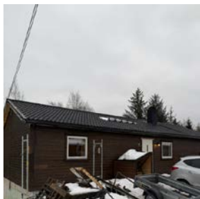
Mangler snøfangere og flassing på beslag
