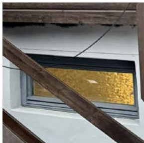
Mangler beslag i bunn av vindu
