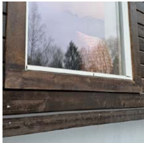
Mangler vannbord i bunn av vindu
