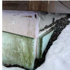
Isolasjon ikke ført helt opp på vegg vest
