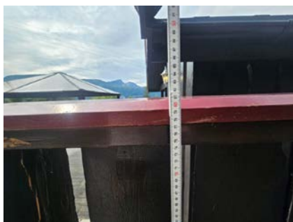
Rekkverk målt til ca.81cm.
