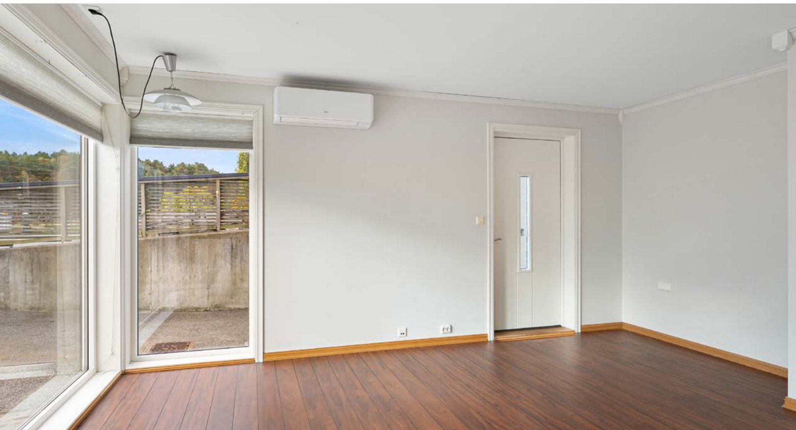
Underetasje hybel: Vannbåren gulvvarme og varmepumpe i hybelen.
