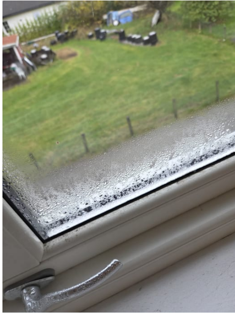
Kondens/fukt på innsiden av vindu i 2.etg.
