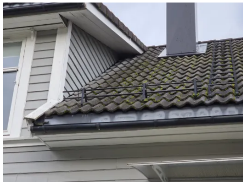
Bilde av takstein, noe mose.
