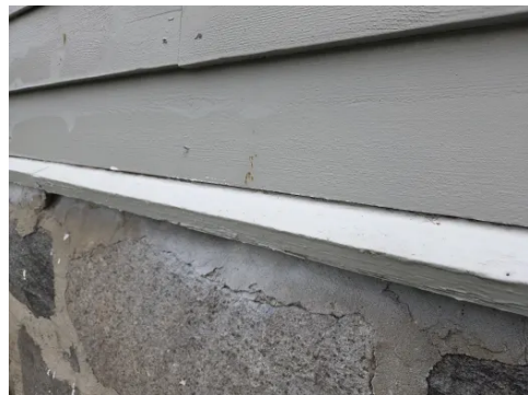
Manglende lufting i bunn av kledning.
