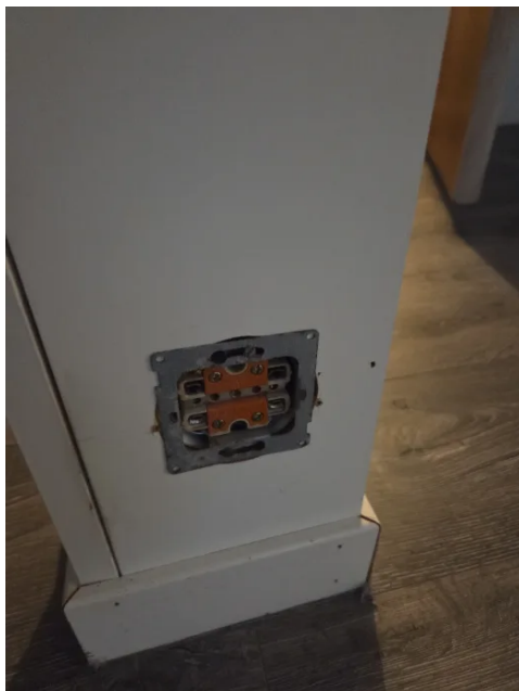
Manglende deksel på kontakt.
