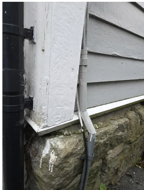
Hjørnebord med råteskader.
