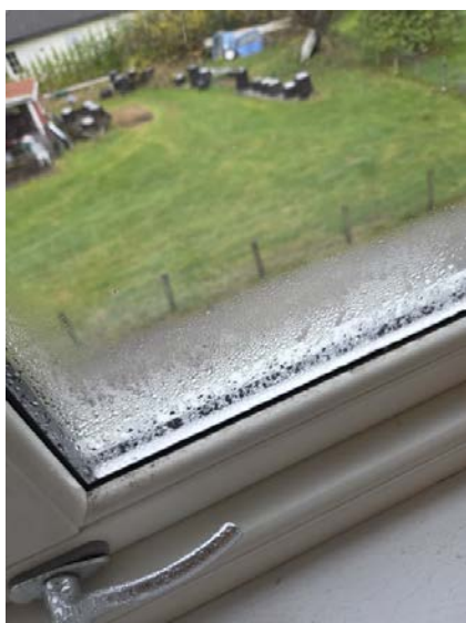
Kondens/fukt på innsiden av vindu i 2.etg.
