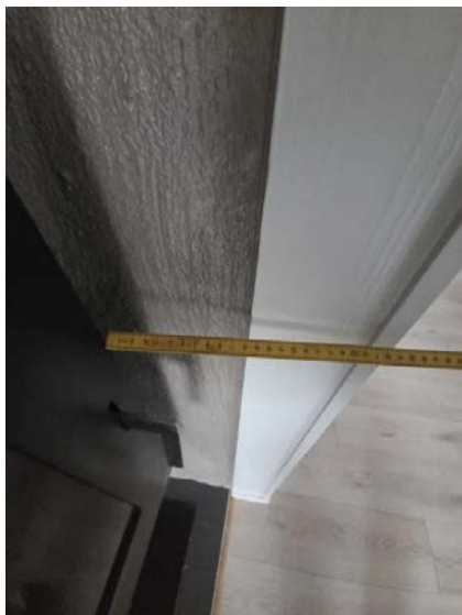
Ca. 11 cm mellom ildsted på kjøkken og treverk på hjørnet av veggen. Kravet er 30cm.
