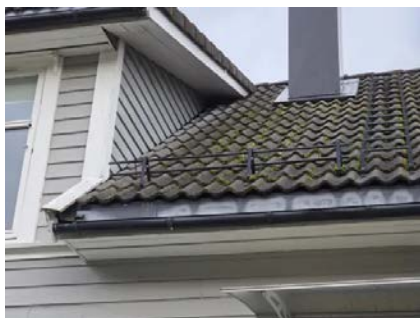
Bilde av takstein, noe mose.
