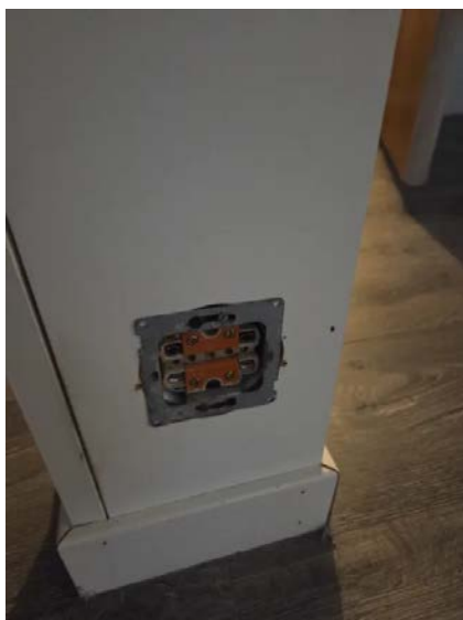
Manglende deksel på kontakt.
