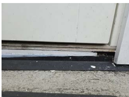
Det må etableres beslag fra karmen til døra og ned over beslag på betongplattning.
