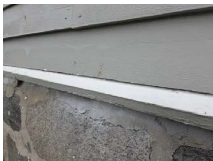
Manglende lufting i bunn av kledning.
