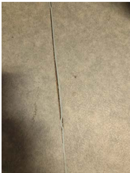
Sprekk i belegg på vaskerom i grovkjeller.
