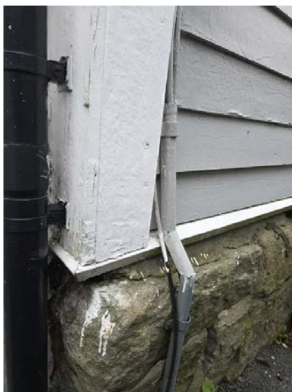
Hjørnebord med råteskader.
