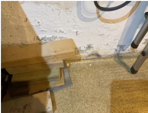
Fuktopptrekk i yttervegg under terreng.
