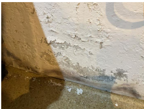
Saltutslag på vegg.
