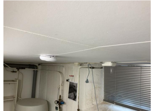
Ujevnt tak i vaskerom.
