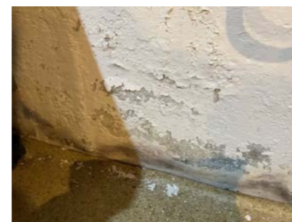
Saltutslag på vegg.
