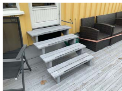
Trapp uten rekkverk til terrasse.
