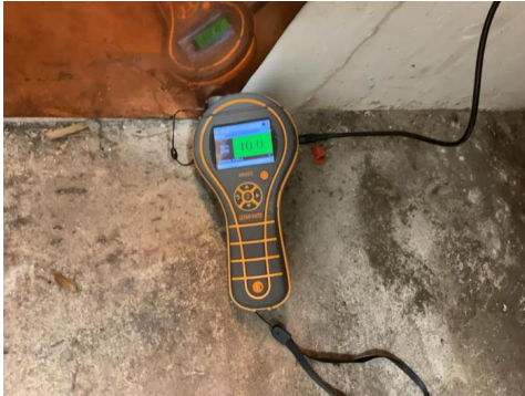
Fuktmåling i trevegg i vaskerom.
