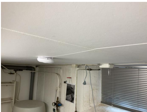
Ujevnt tak i vaskerom.
