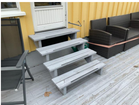
Trapp uten rekkverk til terrasse.
