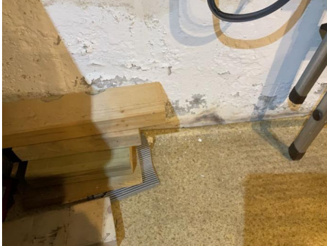
Fuktopptrekk i yttervegg under terreng.
