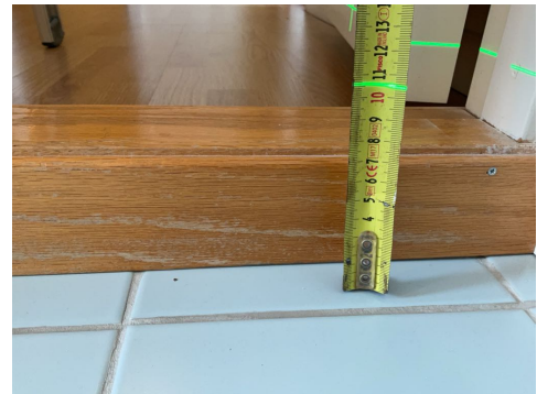
Høyde ved dør 3cm under nivå ved sluk..
