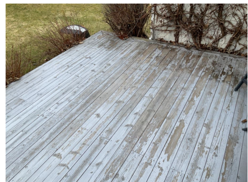
Overflatebehandling på terrasse flasser.
