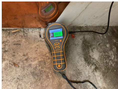
Fuktmåling i trevegg i vaskerom.
