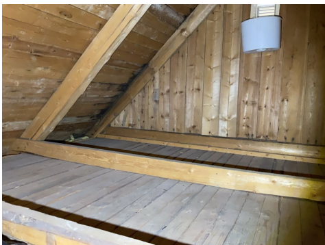
Noe kondensmerker i undertak.
