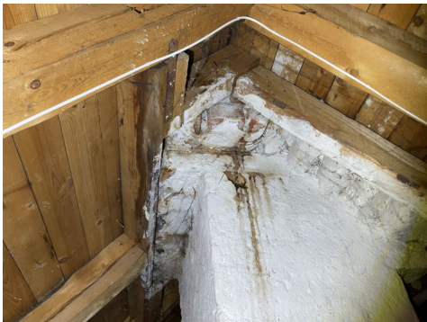
Noe fuktmerker i gjennomgang ved pipe.
