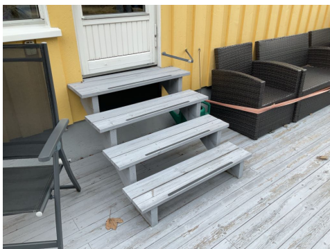
Trapp uten rekkverk til terrasse.
