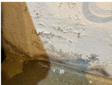
Saltutslag på vegg.
