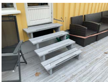
Trapp uten rekkverk til terrasse.
