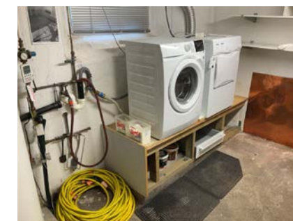
Vaskerom i kjeller.
