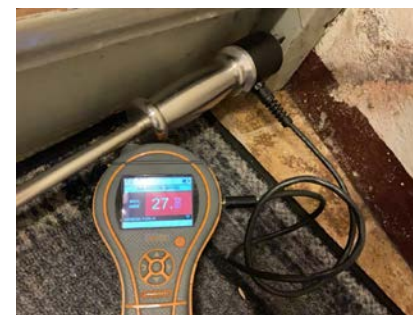
Måling av fukt i trappevange i kjelleren.
