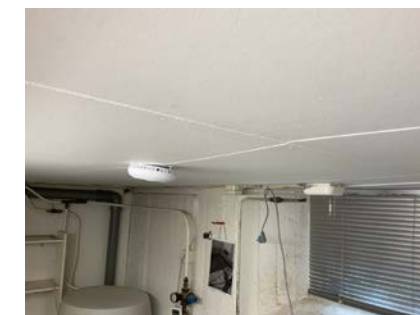
Ujevnt tak i vaskerom.
