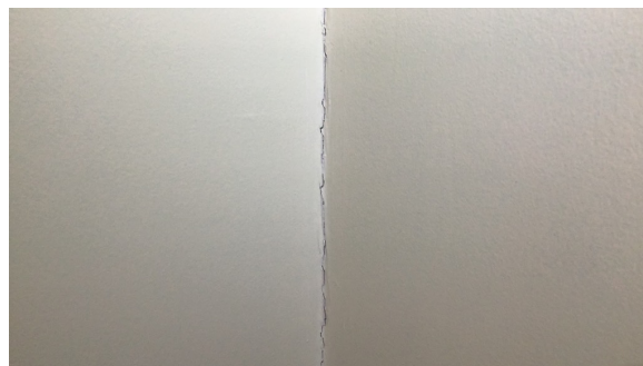
Riss i vegghjørne.
