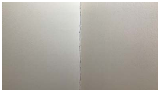
Riss i veggghjørne.
