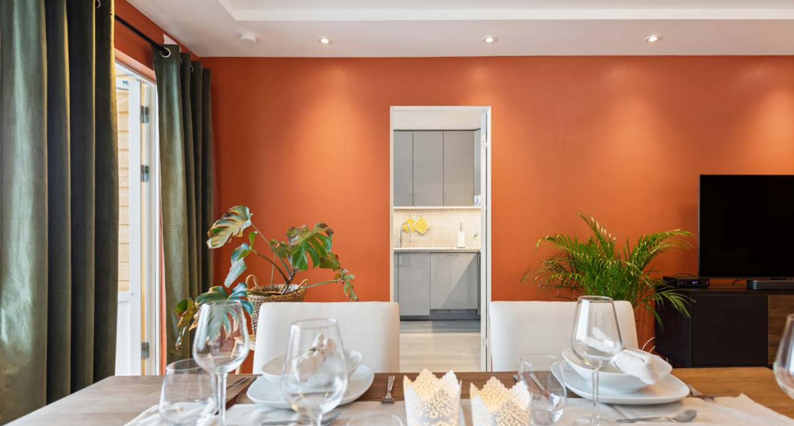
Det er ny varmepumpe i stuen, som er montert under stuevinduet.
