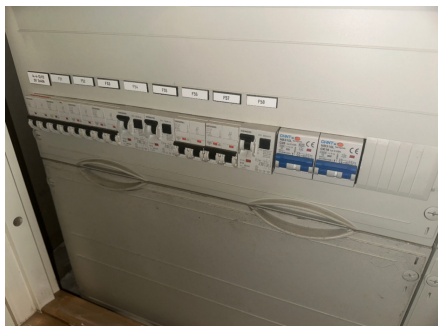
Sikringsskap med automatsikringer.
