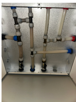
Samleskap med rørkurser og stoppekraner for leilighet
