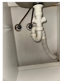
Røropplegg i kjøkkenbenk i hybel
