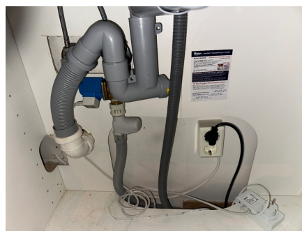
Røropplegg i kjøkkenbenk med Waterguard i leilighet
