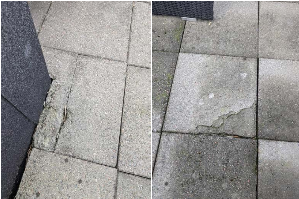
Bildene over viser sprukket og skadet heller.
