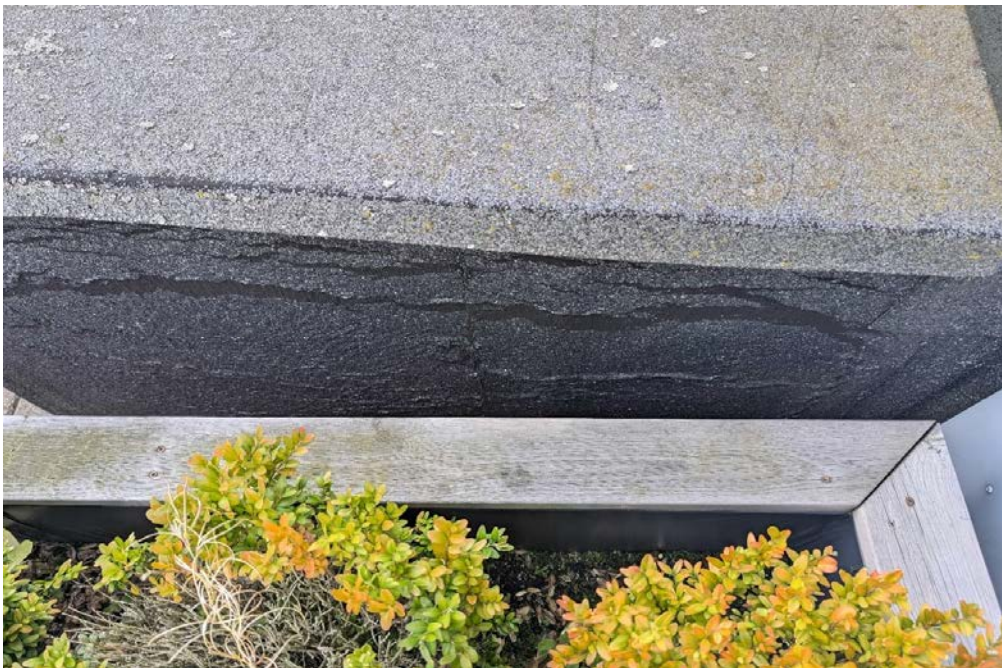
Bilde over viser solskadet membran.
