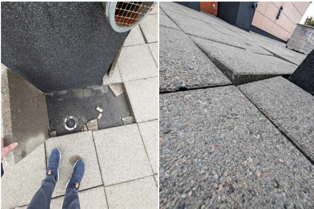
Bildene over viser sluk og ujevne heller.
