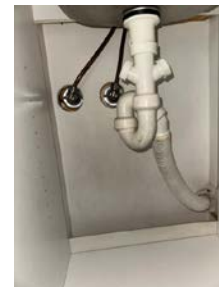
Røropplegg i kjøkkenbenk i hybel
