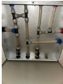
Samleskap med rørkurser og stoppekraner for leilighet
