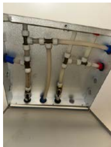
Samleskap med rørkurser og stoppekraner for hybel
