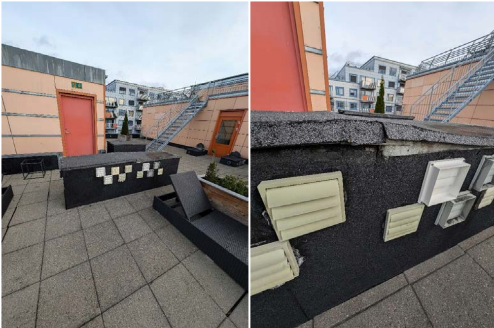
Bildene over viser luftekasse hvor toppen er skadet.
