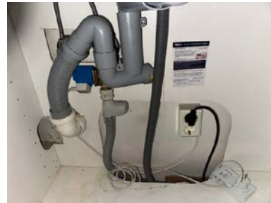
Røropplegg i kjøkkenbenk med Waterguard i leilighet
