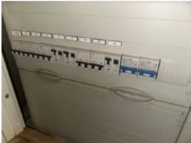
Sikringsskap med automatsikringer.
