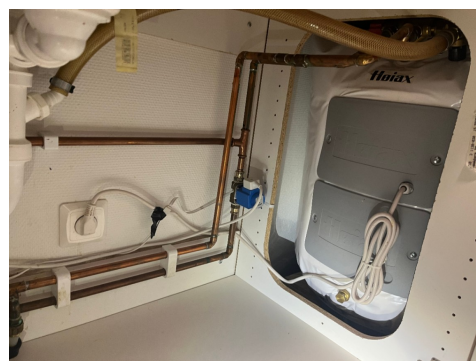
Varmtvannsbereder tilkoblet stikkontakt.
