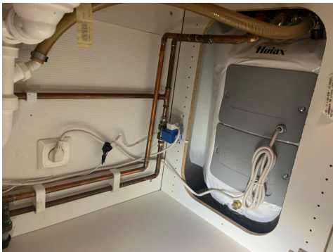
Varmtvannsbereider tilkoblet stikkontakt.
