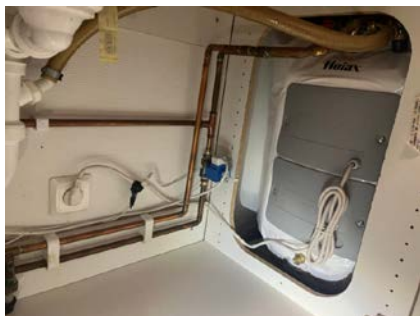
Varmtvannsbereder tilkoblet stikkontakt.
