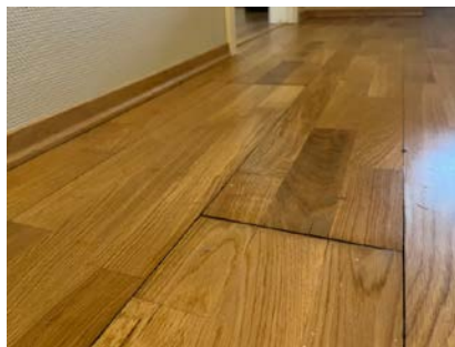
Parkett har slitasje
