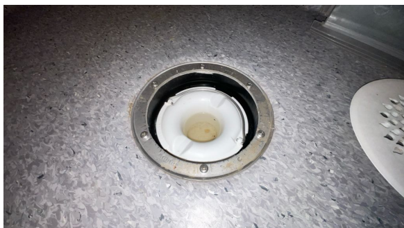
Vinylbelegg er ført ned under skrudd klemring i sluk.
