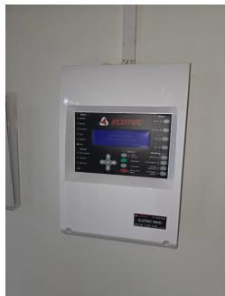
Felles brannsentral i felles gang ved hovedinngang
