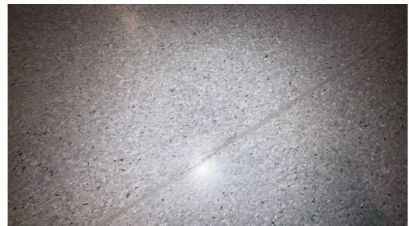
Dårlig utført sveiseskjøt som må kontrolleres i senter av rommet
