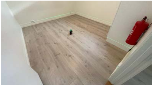
Kjeller. Plassering av laser ved kontroll av soverom. Det er målt 5 mm høydeforskjell gjennom rommet. TG 1
