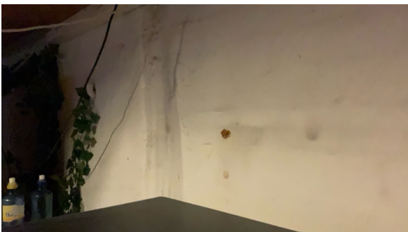
Kjellervegg med moderniseringsbehov.
