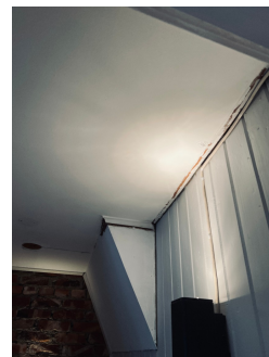
Vegg med moderniseringsbehov.
