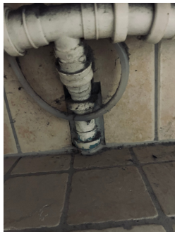
Uheldig løsning med avløpsrør i overgang vegg/gulv.
