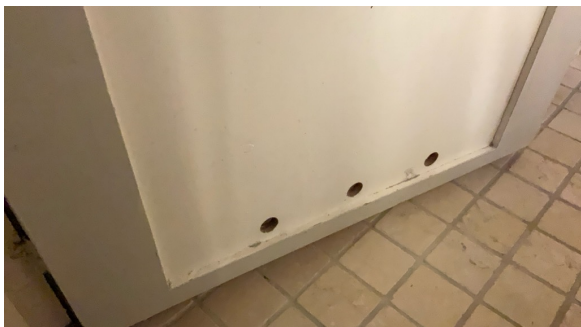
Hull i dør til bad i kjeller.
