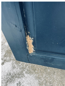
Skade på ytterdør på hagesiden.
