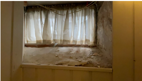
Avflassing på vindusutforing i wc, kjeller.
