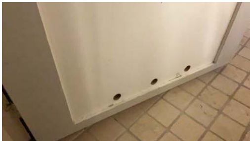
Hull i dør til bad i kjeller.
