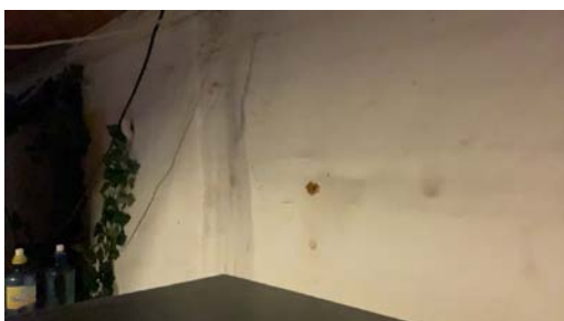
Kjellervegg med moderniseringsbehov.
