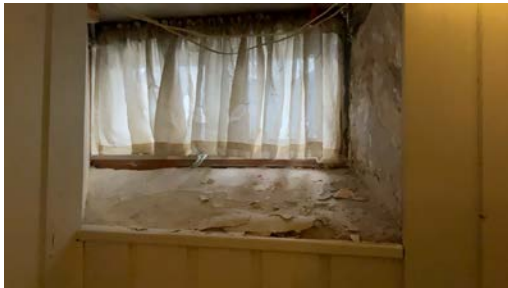
Avflassing på vindusutforing i wc, kjeller.
