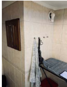
Varmtvannsbereider plassert inne i innkassing.
