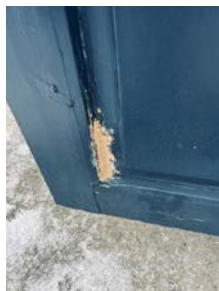
Skade på ytterdør på hagesiden.
