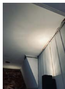
Vegg med moderniseringsbehov.
