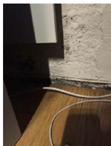
Kjellervegg med moderniseringsbehov.
