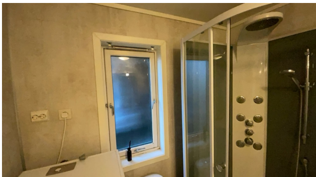
Bad har kun naturlig ventilasjon gjennom vindu.
