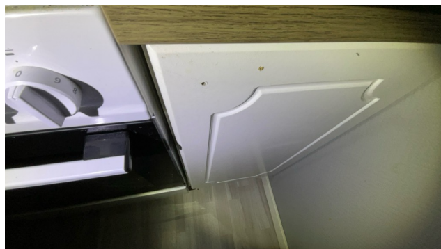
Enkelte småskader i fronter.
