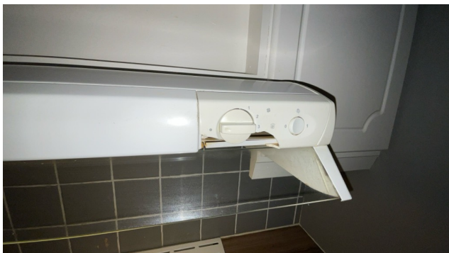
Knekt deksel til bryterpanel på kjøkkenventilator.
