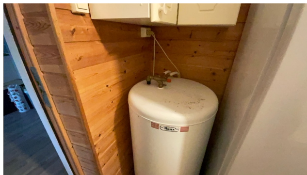
Varmtvannstank fra byggeåret, montert i rom uten sluk,
