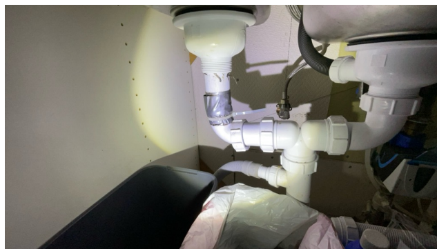
Avløpsrør under vask mangler muffe/overgang og er provisorisk teipet.
