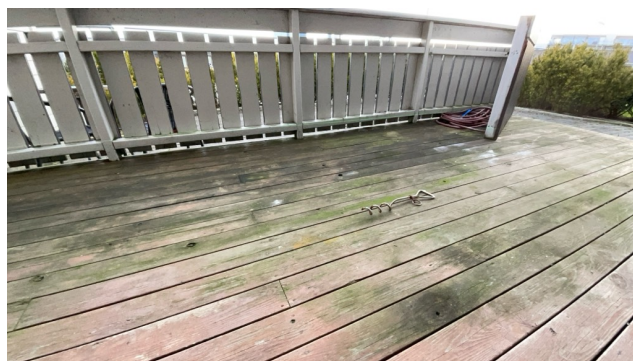
Betydelige skjevheter i terrassegulv.
