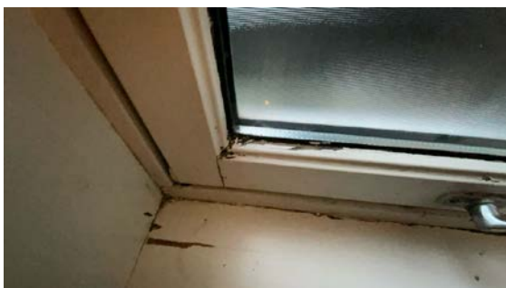
Merker etter kondens i karm til vindu, tyder for lite utskifting av inneluften.
