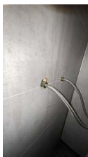
Utette gjennomføringer i vegg i våtsone for dusjnisse.
