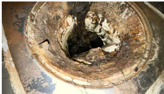
Sluk i gulv, uten synlig membran.
