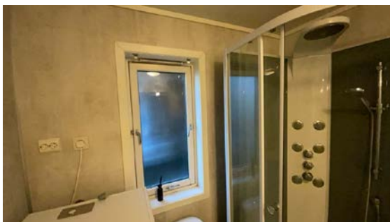
Bad har kun naturlig ventilasjon gjennom vindu.
