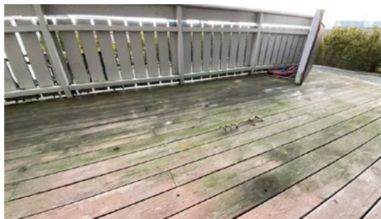
Betydelige skjevheter i terrassegulv.
