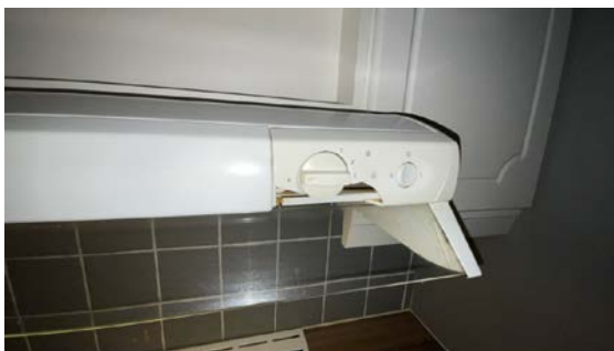
Knekt deksel til bryterpanel på kjøkkenventilator.
