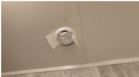
Funksjonstest av avtrekk.
