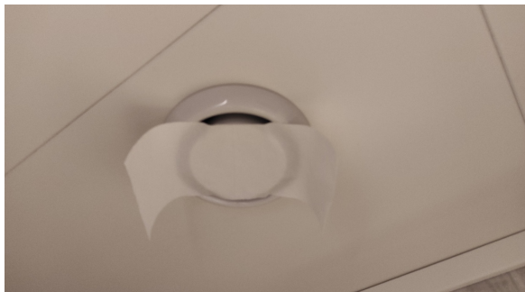
Funksjonstest av avtrekk.
