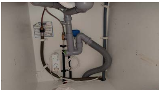
Kontroll etter lekkasjer.
