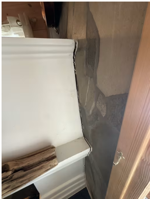
Det registreres sprekk mellom vegg og ildsted. Anbefaler ytterligere undersøkelser.
