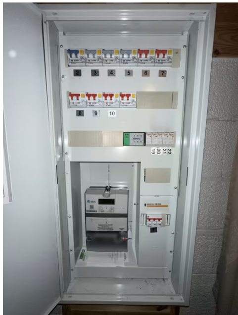
Viser sikringskapp plassert på soverom.
