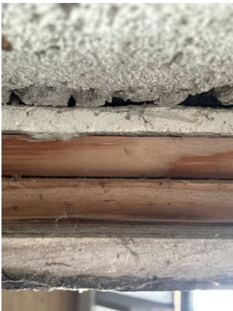
Viser manglende lufting av kledningen på anneks.
