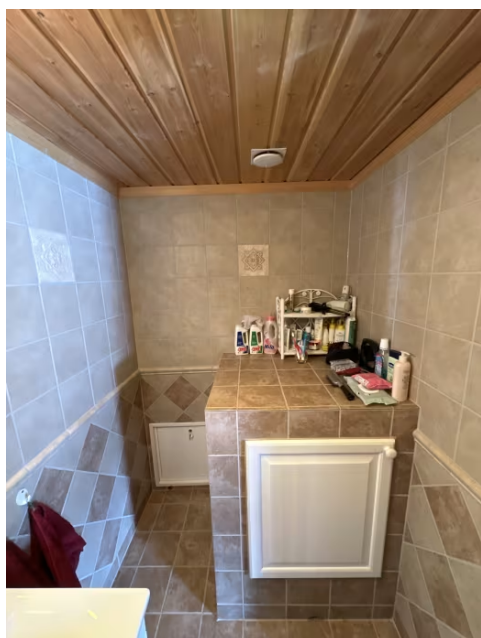
Viser kasse for varmtvannsbereder og innfelt fordelerskap.
