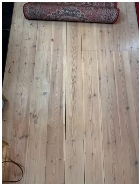
Det registreres stedvis glipper i gulv.
