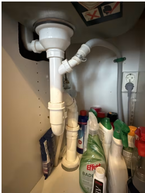
Viser vann og avløpsinstallasjoner under kum.
