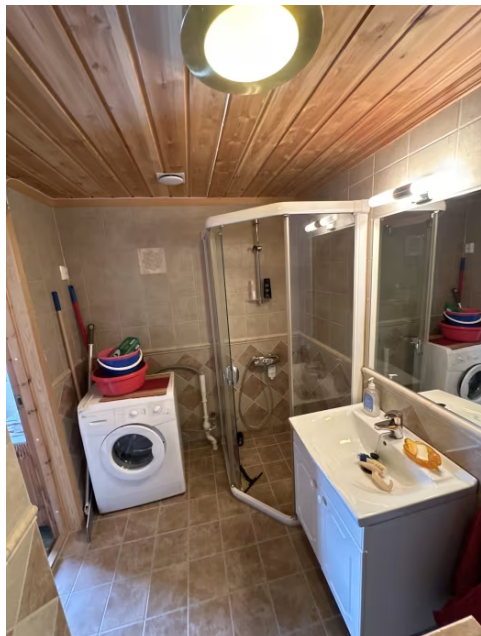
Viser bad og installasjoner.
