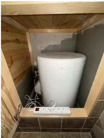
Viser innkasset bereder plassert på bad.
