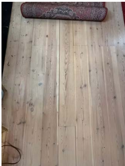
Det registreres stedvis glipper i gulv.
