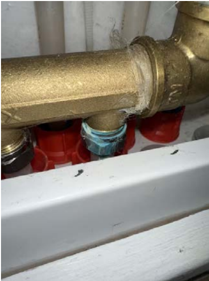
Det registreres irr på kobling i fordelerskap. Anbefaler ytterligere undersøkelser.
