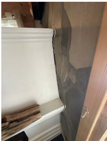
Det registreres sprekke mellom vegg og ildsted. Anbefaler ytterligere undersøkelser.
