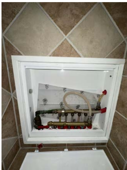
Vannrør med rør i rør system fra fordelerskap plassert på bad og frem til sanitærinstallasjoner på baderom, toalettrom og kjøkken. Hovedstoppekran og inntak i skap.
