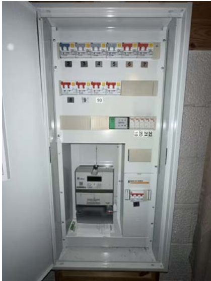
Viser sikringskap plassert på soverom.
