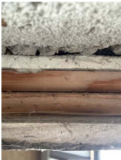
Viser manglende lufting av kledningen på anneks.
