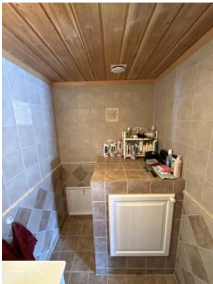
Viser kasse for varmtvannsbereider og innfelt fordelerskap.
