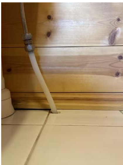
Det registreres skjevheter ved gulv. Sprekk mellom flis og listverk.
