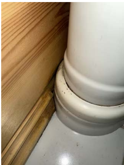
Det er spor etter tidligere kondens/lekkasje ved listverk ved toalett.
