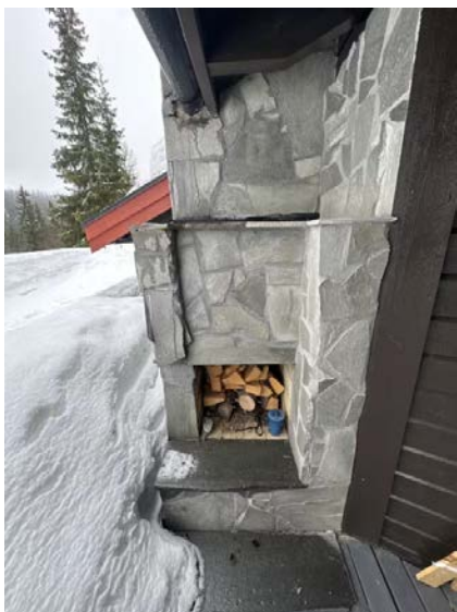
Viser utvendig åpen peis.
