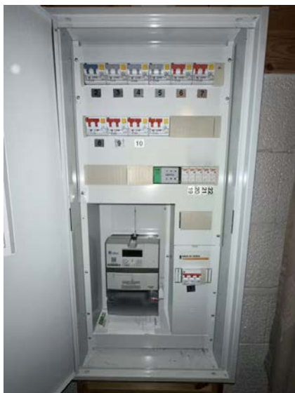
Viser sikringsskap plassert på soverom.
