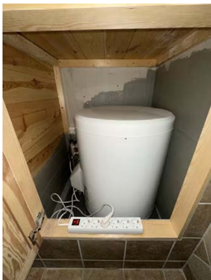
Viser innkasset bereder plassert på bad.
