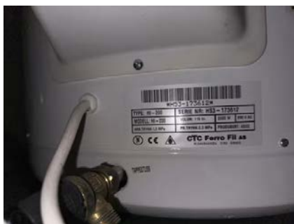
Viser teknisk data på bereder.
