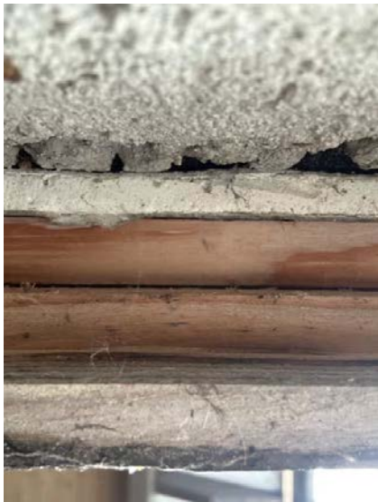
Viser manglende lufting av kledningen på annekset.
