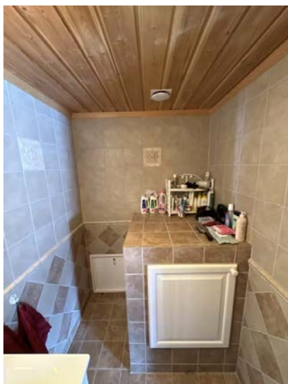
Viser kasse for varmtvannsbereder og innfelt fordelerskap.
