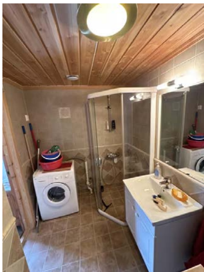
Viser bad og installasjoner.
