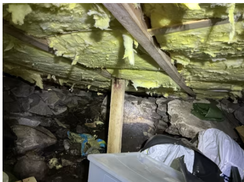
Vann blir ledet på bakke under boligen.
