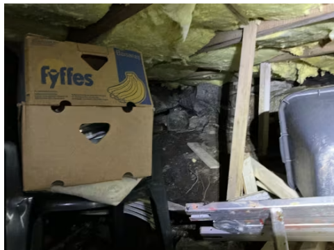
Bjelkelag er støttet opp med tilfeldige støtter-
