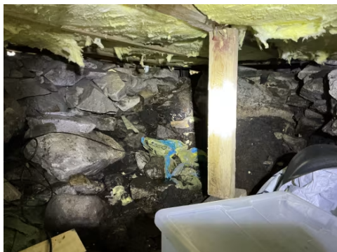
Isolasjon i bjelkelag. Ingen fukt-sikring/vindtetting inder isolasjon er etablert.
