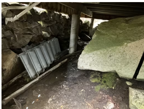
Ansamling av vann mot ringmur.
