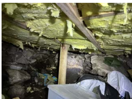
Vann blir ledet på bakke under boligen.
