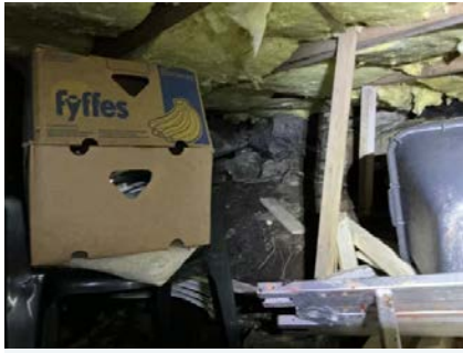
Bjelkelag er støttet opp med tilfeldige støtter-
