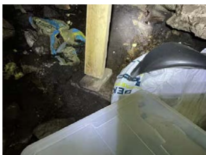
Bjelkelag er støttet opp med tilfeldige støtter uten fundament mot grunn.
