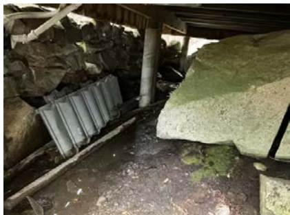
Ansamling av vann mot ringmur.
