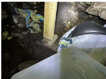
Bjerkelag er støttet opp med tilfeldige støtter uten fundament mot grunn.
