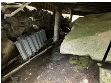
Ansamling av vann mot ringmur.
