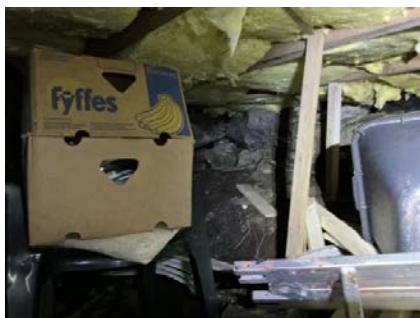
Bjelkelag er støttet opp med tilfeldige støtter-
