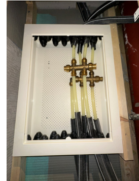
Samleskap med rørkurser og stoppekraner
