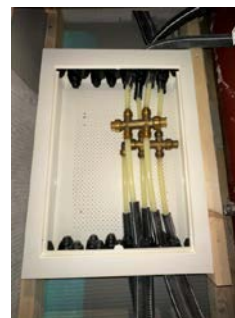
Samleskap med rørkurser og stoppekraner
