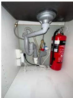
Røropplegg i kjøkkenbenk med Waterguard
