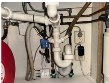
Røropplegg i kjøkkenbenk med Waterguard
