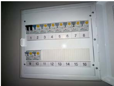
Sikringsskap med automatsikringer.
