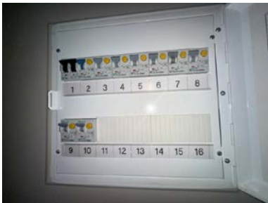
Sikringsskap med automatsikringer.
