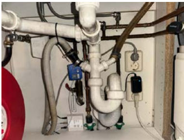
Røropplegg i kjøkkenbenk med Waterguard
