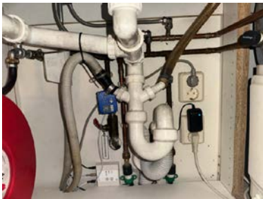
Røropplegg i kjøkkenbenk med Waterguard
