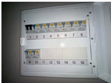
Sikringskap med automatsikringer.
