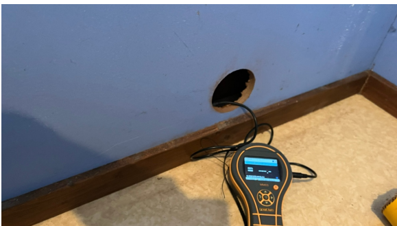
Fuktmåling mot vaskerommet
