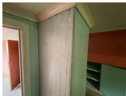
Merker etter sotrenninger på pipe.
