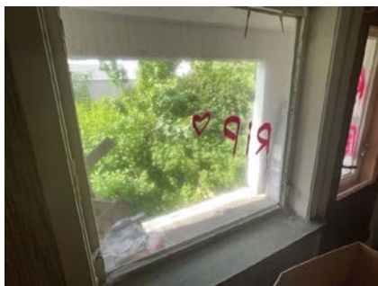
Hærverk/tagging på vindu.
