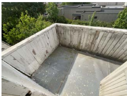
Balkong fra loft. Råteskader i rekkverk.
