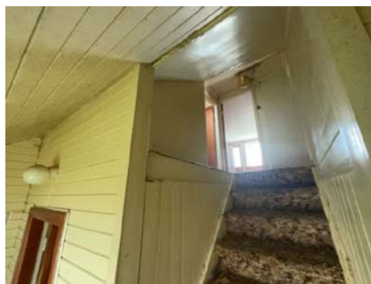
Trapp er ikke sikret med rekkverk på loft.
