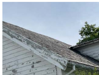
Det er registrert nedbøy i takkonstruksjonen.
