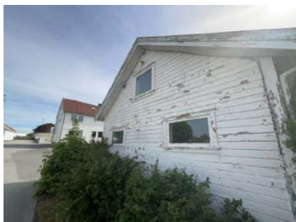
Vegetasjon vokser opp inntil kledning.
