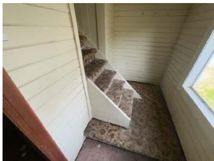
Trapp mangler håndrekke og rekkverk i nedre ende.
