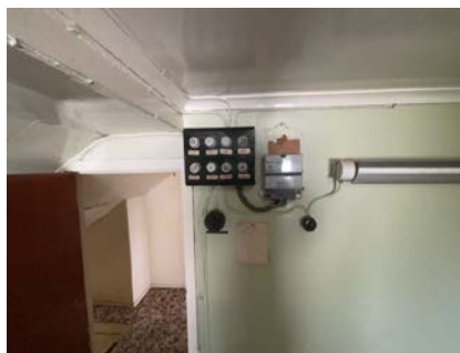
Sikringsboks på vegg på loft.
