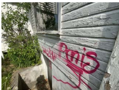
Kledning har malingslitasje og det er utført hærverk/tagging flere steder.
