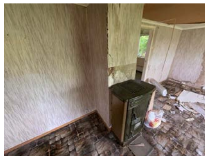
Sprekker i pipe i stue.
