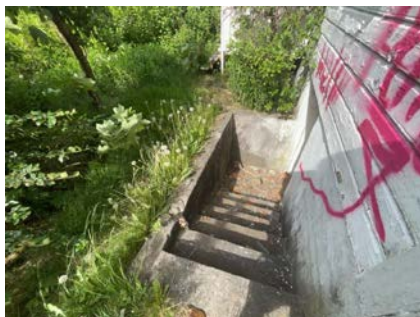
Trapp til kjeller er ikke sikret med rekkverk.
