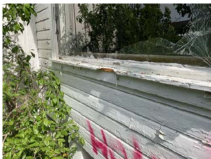
Skader i vannbord til vindu.
