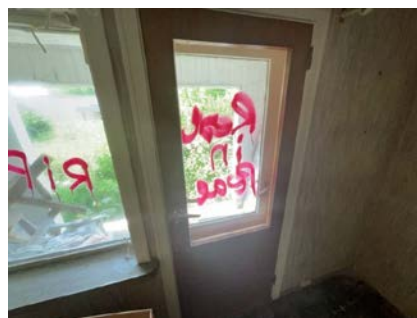
Koblede terrassedører i tre. Terrassedør i stue er sprayet/tagget utvendig.
