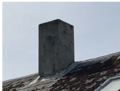
Riss/sprekker i puss på pipe over tak.
