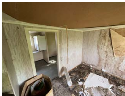
Lampe i stue henger løst etter ledning.
