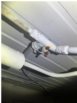
Jording på rør har rustet tilkobling.
