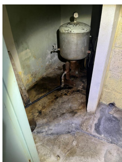
Fall til sluk. Hull i vegg fra vaskerom. Alle vegger av mur.
