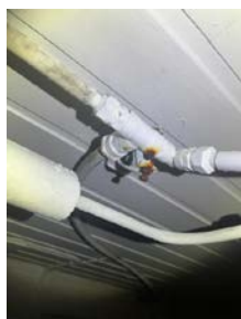
Jording på rør har rustet tilkobling.
